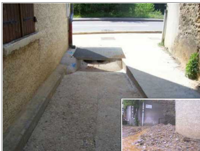
Figure III.14: la combe de la Raze débouche sur le chemin du même nom puis sur la RD538. En médaillon, débordement de la combe sur la RD538 en 2008.
