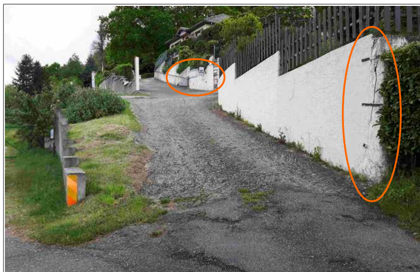
Figure III.15: signes de mouvements de terrain à l'amont du chemin de La Raze (murs de clôture fissurés et renforcés).
