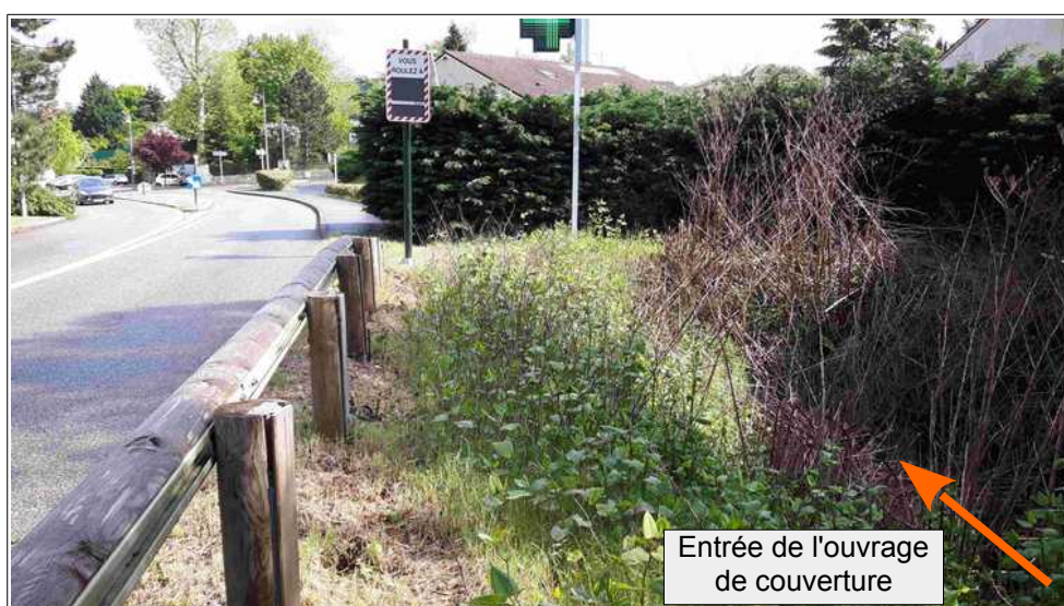
Figure III.9: couverture du ruisseau de Bérardier à l'amont de la pharmacie. En cas d'obstruction de l'ouvrage, le ruisseau peut se déverser sur la RD538.
